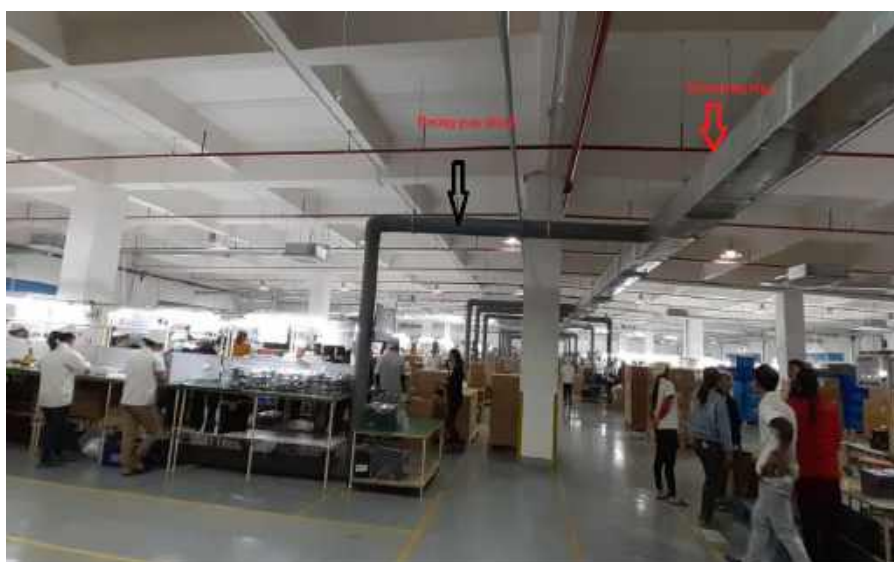
Đường gom nhánh, đường ống tổng tại tầng 2 xưởng 2
