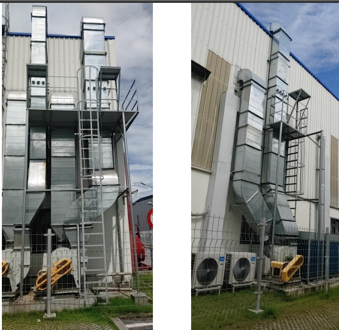
Hình 1. 11. Hệ thống thu gom khí thải xưởng gia công (trái), xưởng lắp ráp (phải).
