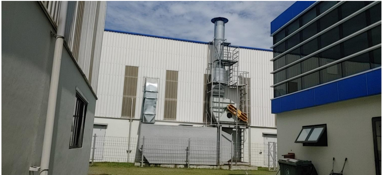
Hình 1. 8. Hệ thống xử lý khí thải xưởng sơn điện di và phòng làm sạch.
