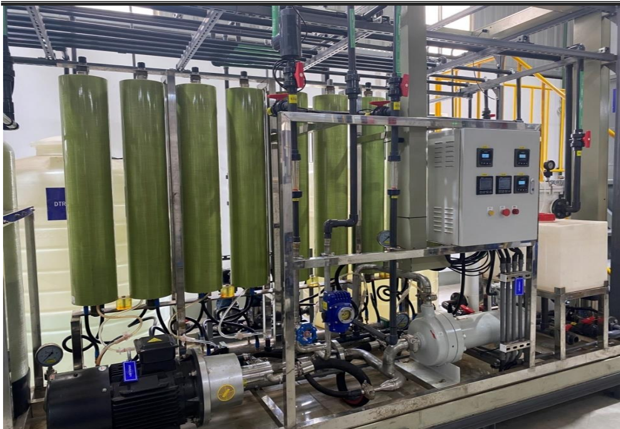
Hình 1. 5. Hình ảnh về hệ thống xử lý nước thải dây chuyền sơn điện di.
