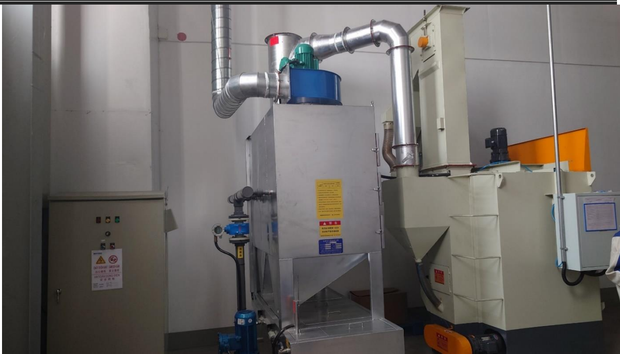
Hình 3. 9. Hệ thống thu gom, xử lý bụi buồng phun bi.
