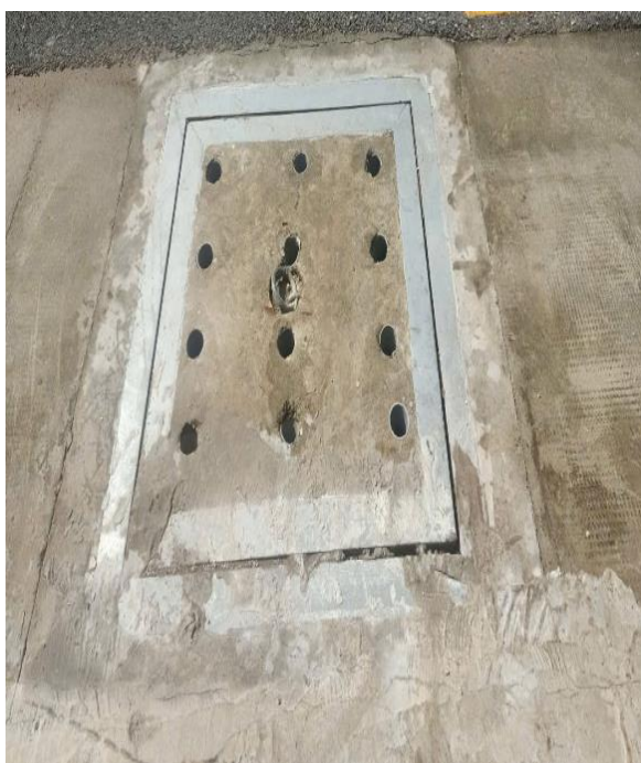
Hố ga thu gom nước mưa
