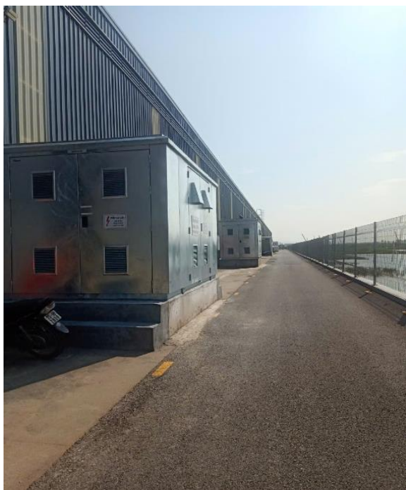
Vị trí trạm biến áp
