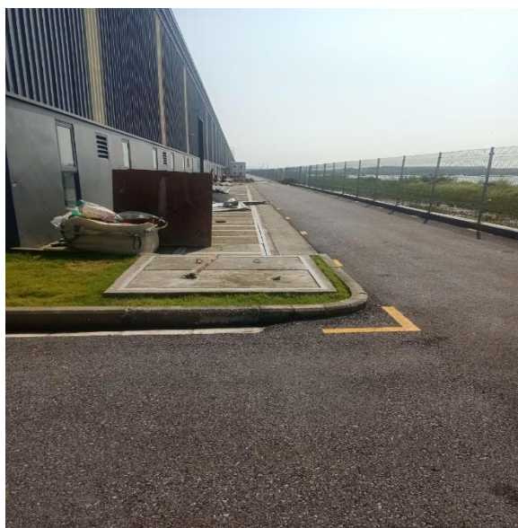
Hố ga cuối thoát nước mưa
