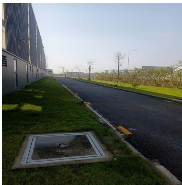
Hố ga thu gom nước mưa
