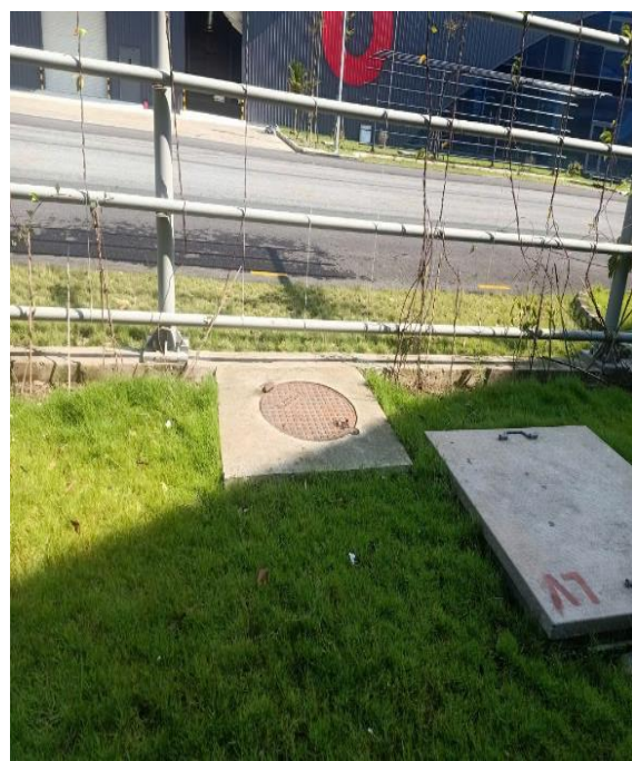
Hố ga thu gom nước thải
