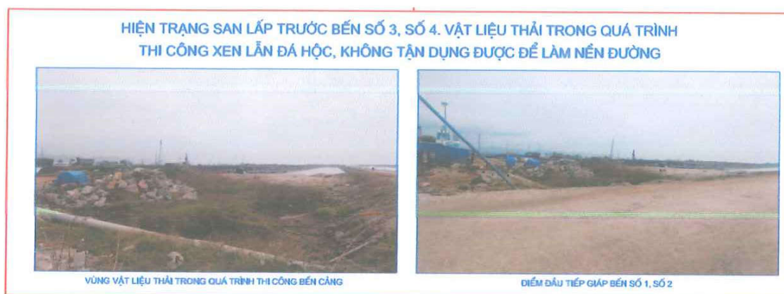
Hình 9. Hiện trạng san lấp trước bến số 3,4; vật liệu thải trong quá trình thi công xen lẫn đá hộc không tận dụng để làm nền đường
