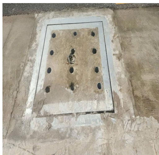
Hố ga thu gom nước mưa
