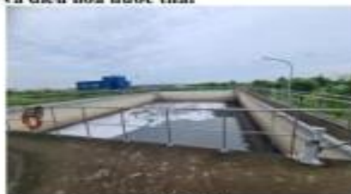
Bể điều hòa
