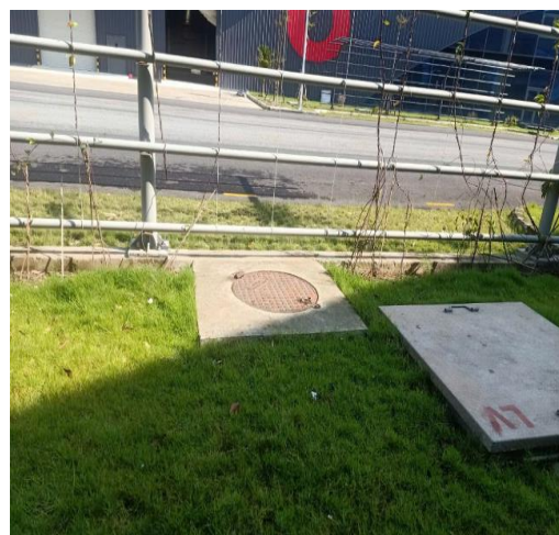
Hố ga thu gom nước thải
