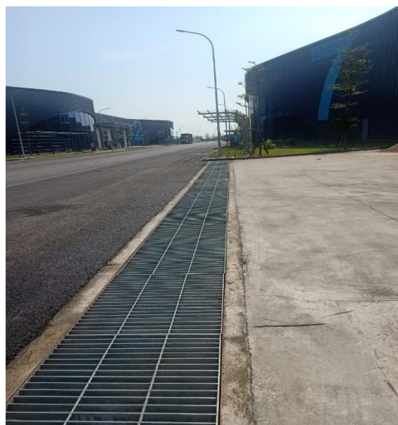
Mương thu gom nước mưa
