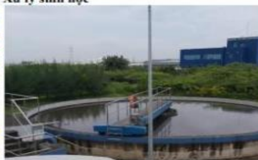
Bể lắng sinh học
