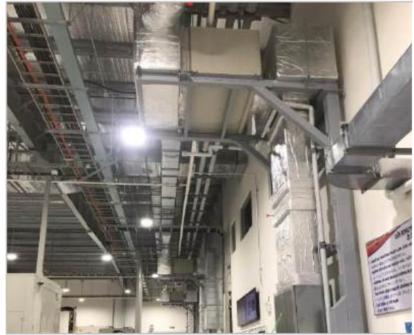
Hệ thống điều hòa
