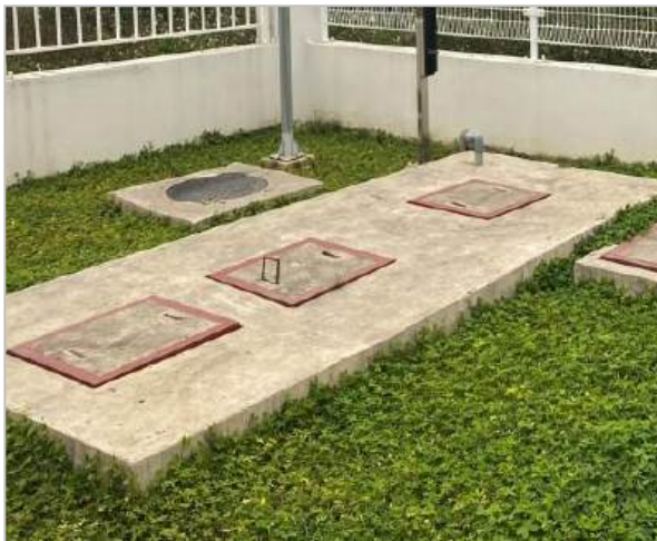
Bể tự hoại
