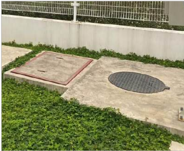
Hố thu gom nước thải
