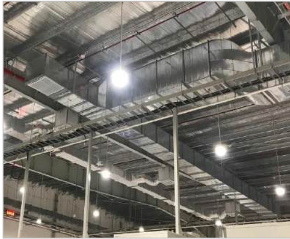
Hệ thống thông gió
