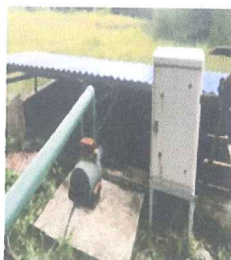
Bể thu gom
