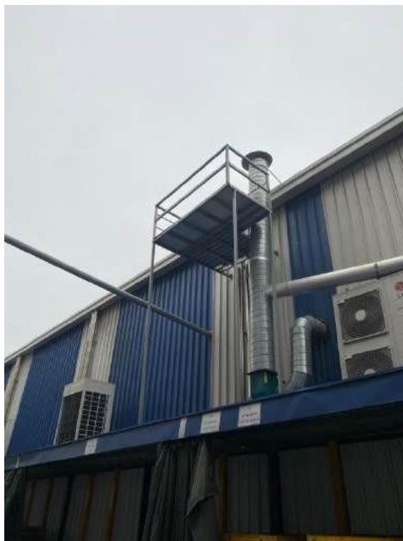
Hình ảnh ống phóng không của hệ thống thu gom khí thải xưởng V4
