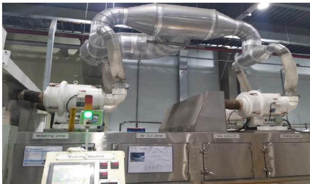
Hình ảnh thiết bị rửa (làm sạch) tự động cùng bộ hút hơi dầu của dự án
