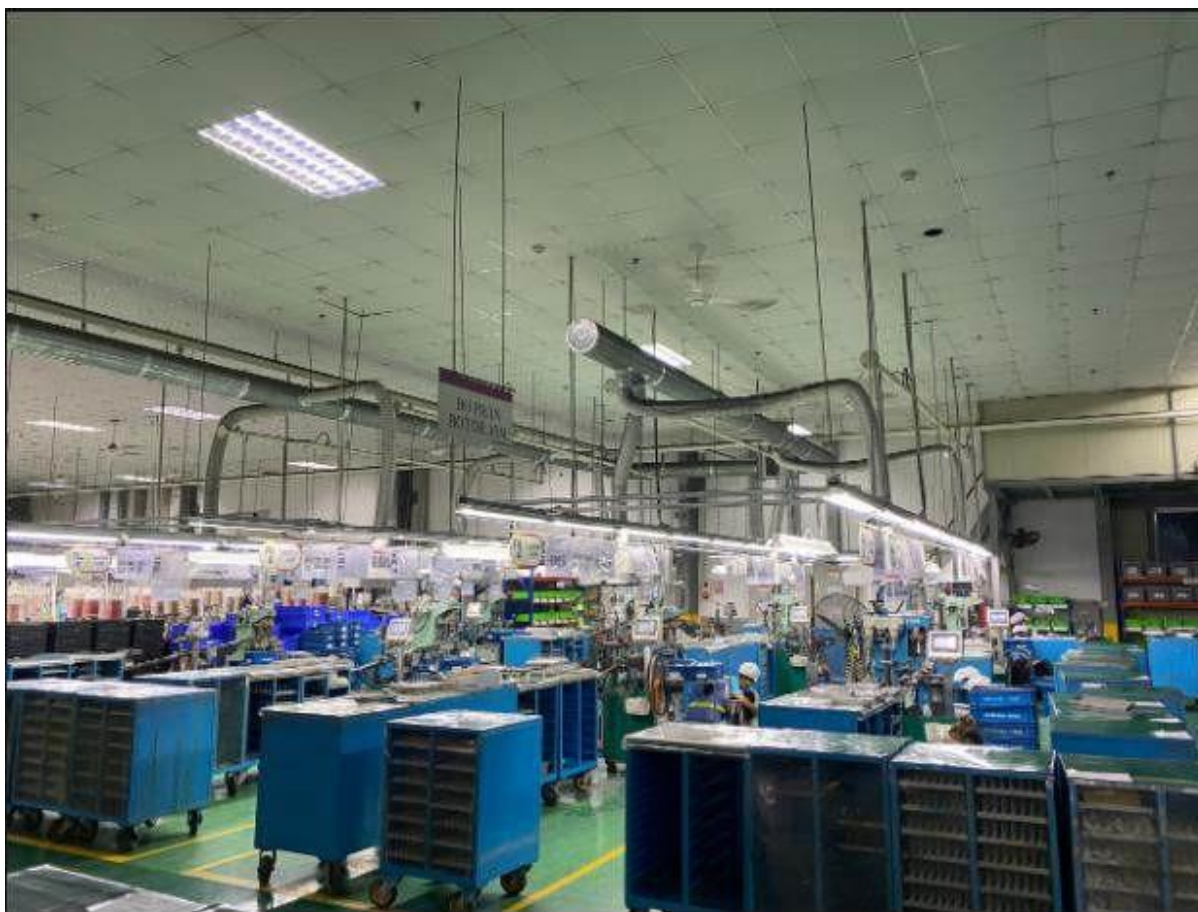
Hình ảnh hệ thống thu gom hơi sơn, hơi dầu xưởng V1
