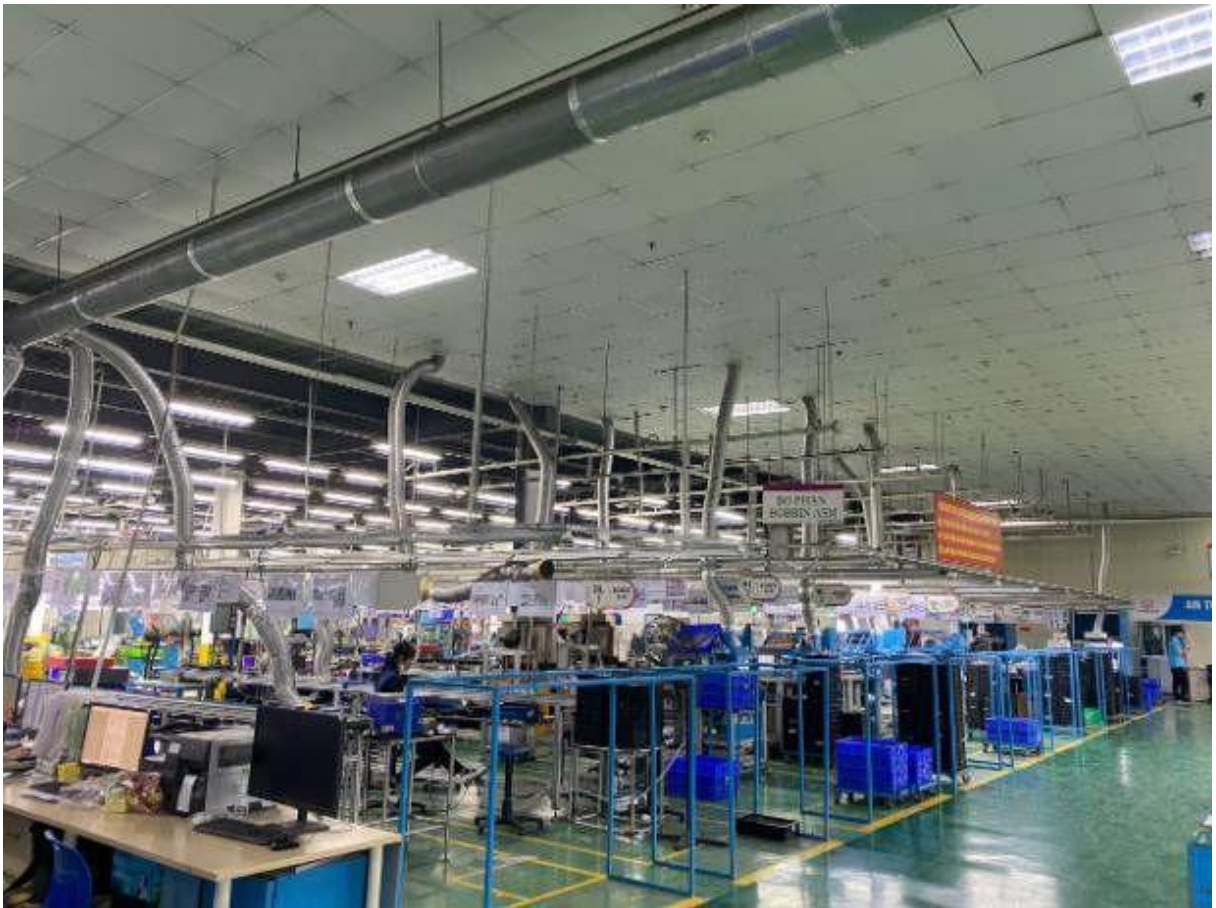
Hình ảnh hệ thống thu gom hơi thiếc xưởng V1
