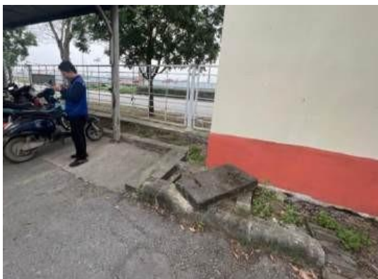
Hình ảnh hố ga thoát nước thải cuối của Dự án
