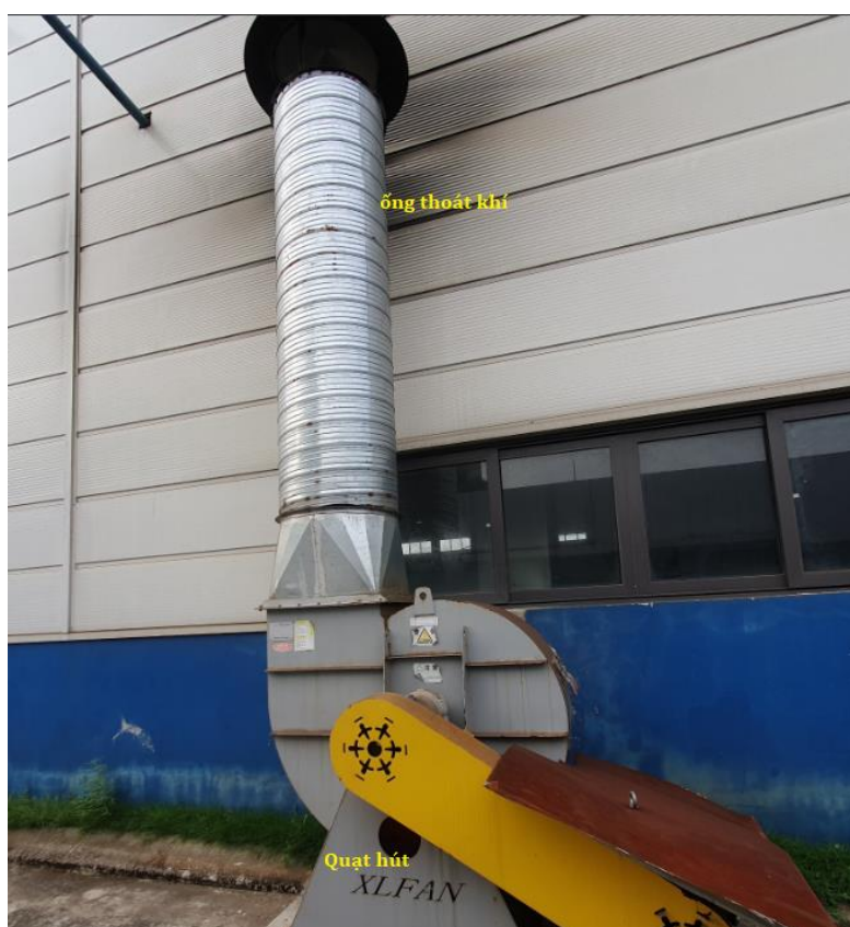
Hình 4.6. Hệ thống xử lý bụi, khí thải từ dây chuyền sơn, sấy đĩa phanh và chuyền làm sạch, nhúng dầu chống gỉ đĩa phanh (tham khảo Công ty TNHH chế tạo máy Yuekai (Thửa C-16, Lô đất CN9 bên cạnh, đây là Công ty cùng tập đoàn để sản xuất phôi đĩa phanh ô tô)
