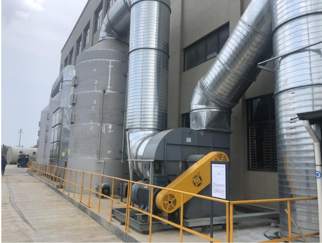
Hình 4.8. Hệ thống xử lý bụi, khí thải từ sản xuất PV film (minh họa hệ thống tại Trung Quốc)
